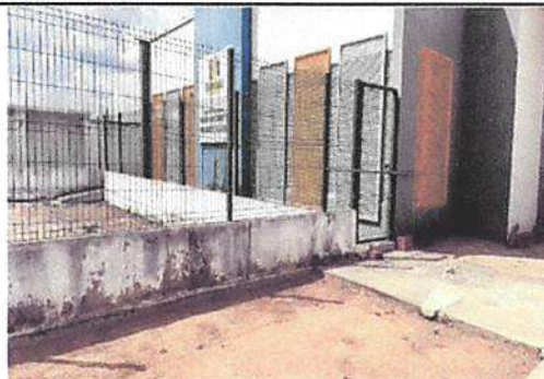
Impermeabilizar revestimento e refazer pintura
