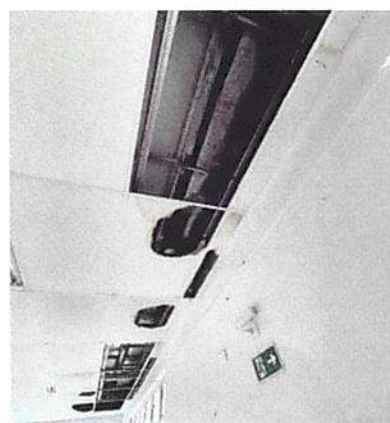
Substituir placas de Gesso Mineral danificadas
