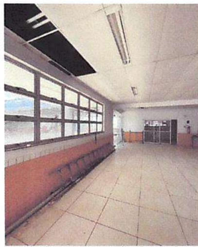
Corrigir falhas de impermeabilização/vedação em calhas de cobertura
