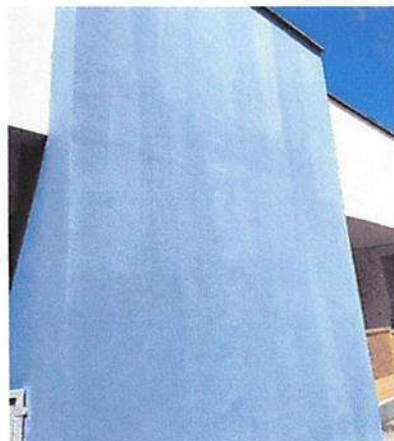
Refazer pintura em área desgastada
