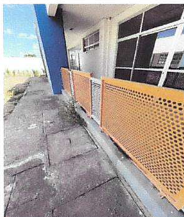
Recuperar Chapa e Refazer pintura
