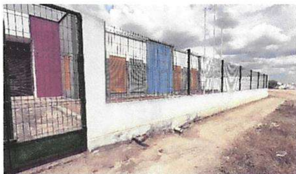
Impermeabilizar revestimento e refazer pintura
